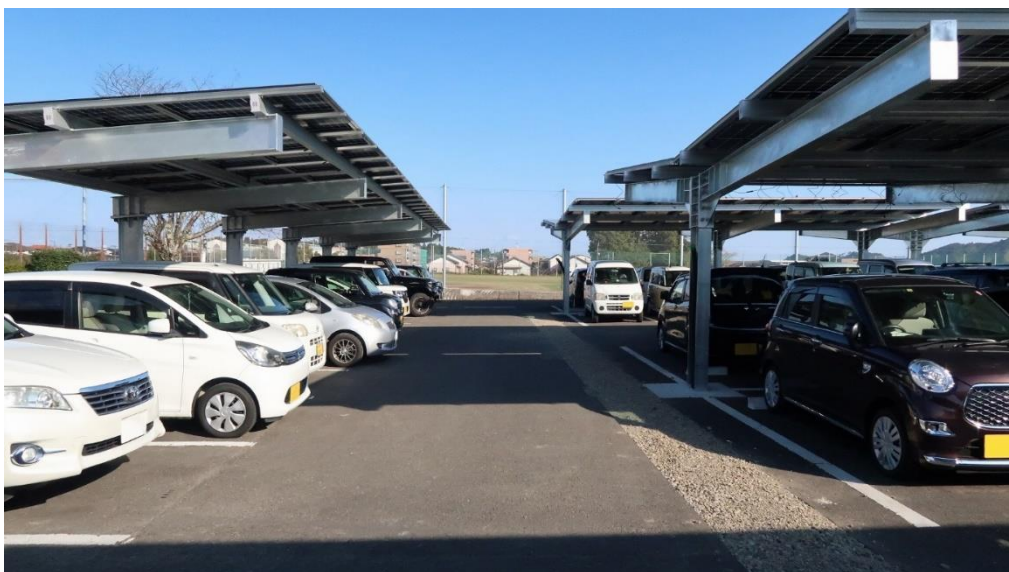
地上から撮影したソーラーカーポート
