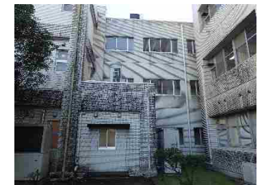
▲農学部：外壁の老朽化
