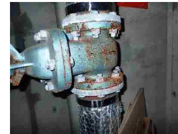
▲農学部：配管の腐食（サビ）
