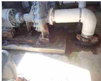
▲ポンプ室：配管の腐食による水漏れ
