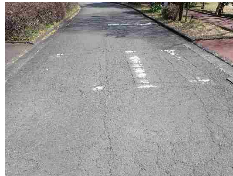
▲安全でない道路(横断歩道も消えている)
