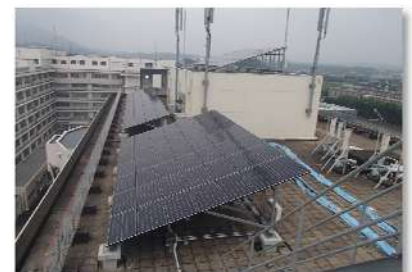
▲太陽光発電設備
