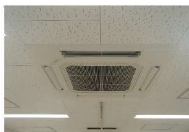
▲省エネ型空調機
