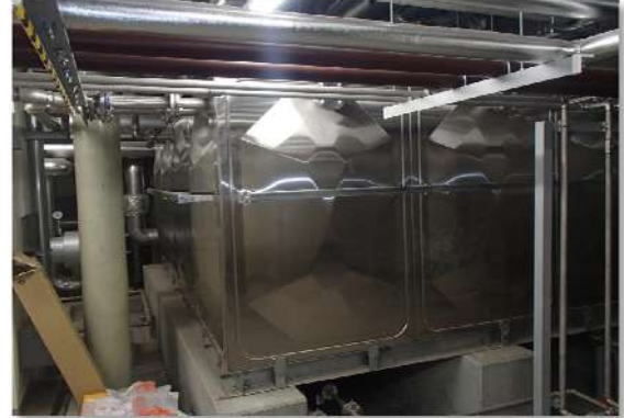
▲ 感染系排水処理施設原水槽
