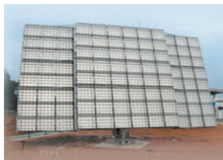
J-クレジット制度対象施設 体育館北側1 定格出力:14kW
