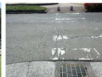
図 6-2-4. 老朽化した車道
