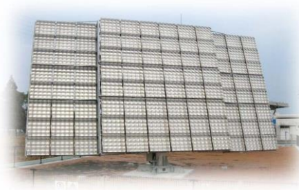
▲J-クレジット制度対象施設 体育館北側 1 定格出力：14kW
