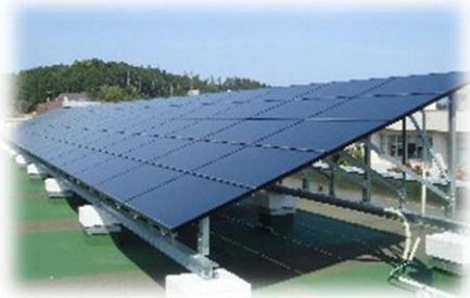
▲J-クレジット制度対象施設 教育学部実験研究棟／技術家庭棟 定格出力：60kW／40kW
